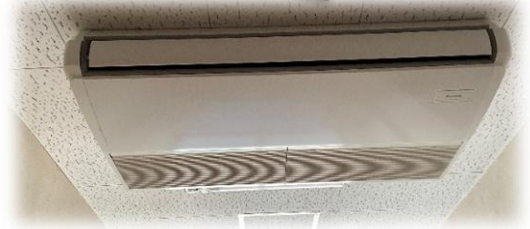
2F 男女棟新エアコン
